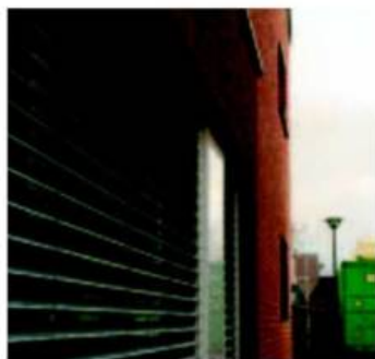
Système de ventilation.
